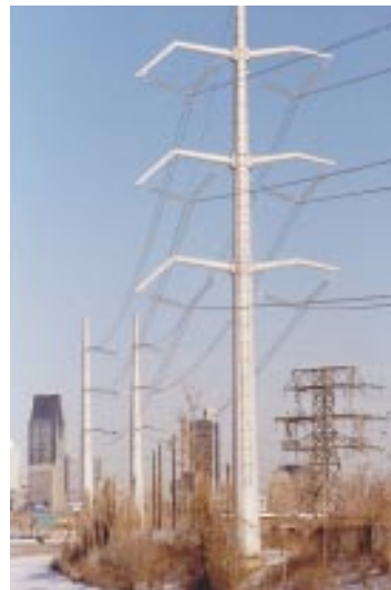
Bouclage du centre-ville de Montréal : ligne reliant le poste de l'Aqueduc au poste Atwater.
