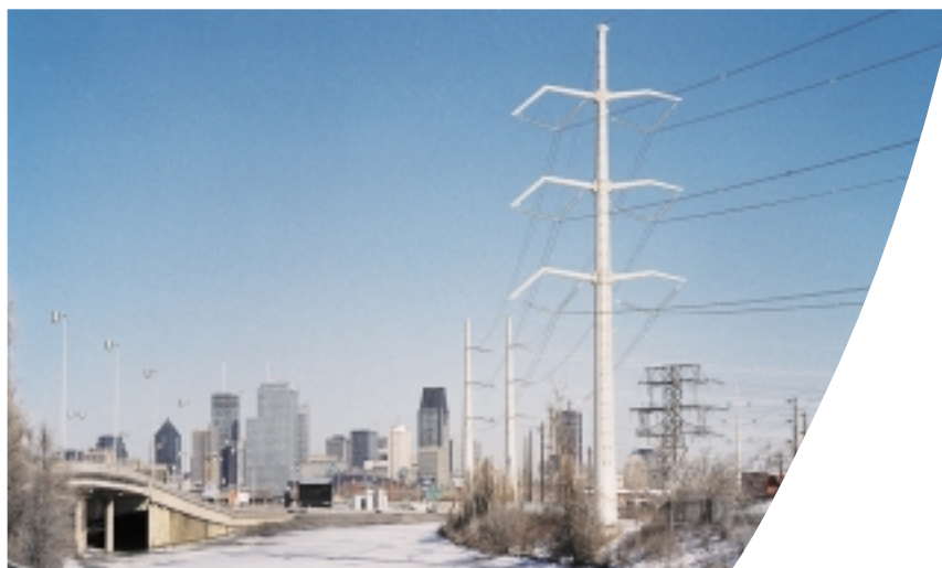
Ligne à 315 kV Aqueduc - Atwater - Viger
