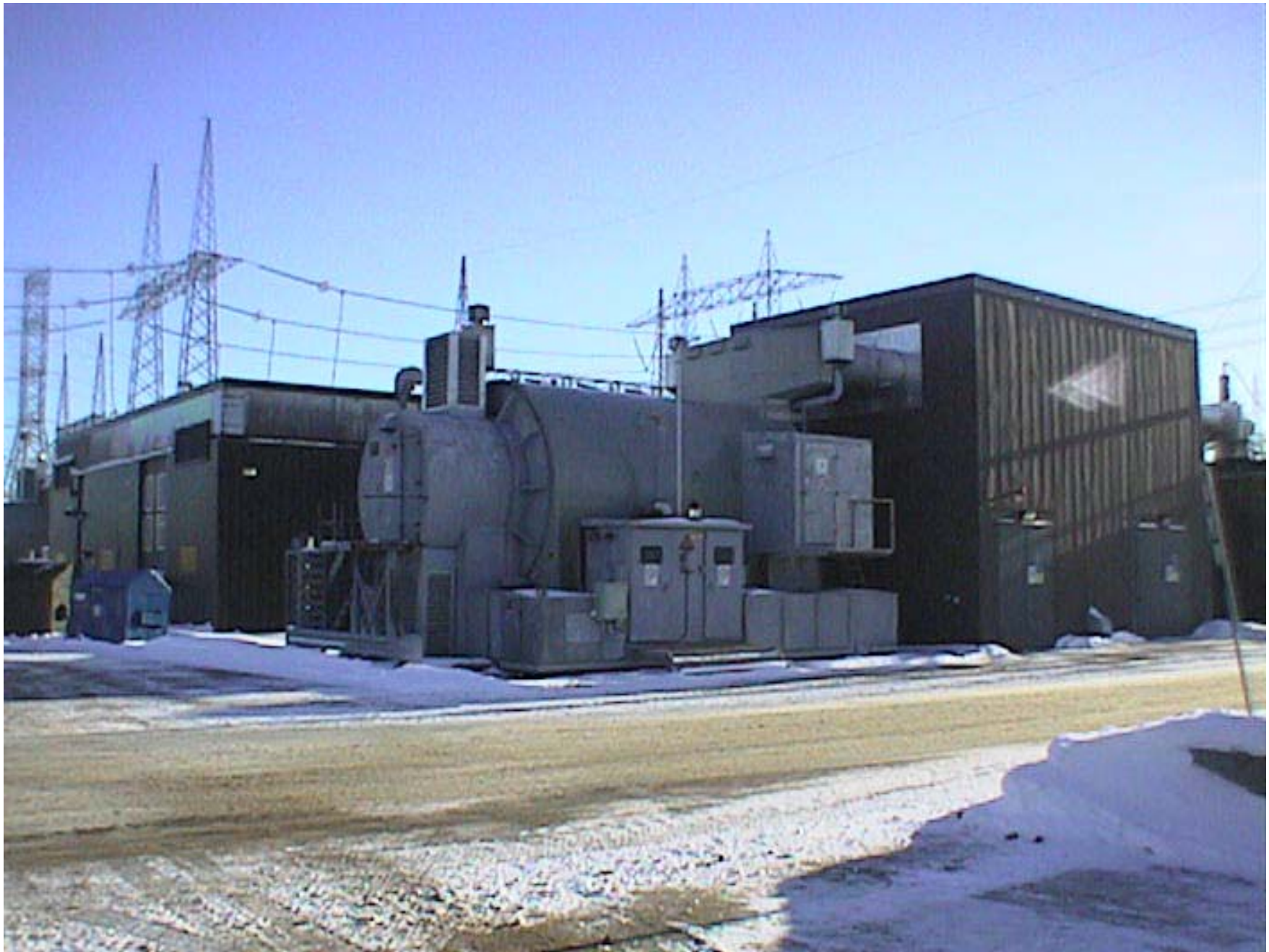
Photo montrant la partie moteur du CS32 ainsi que le bâtiment de démarrage et de commande
