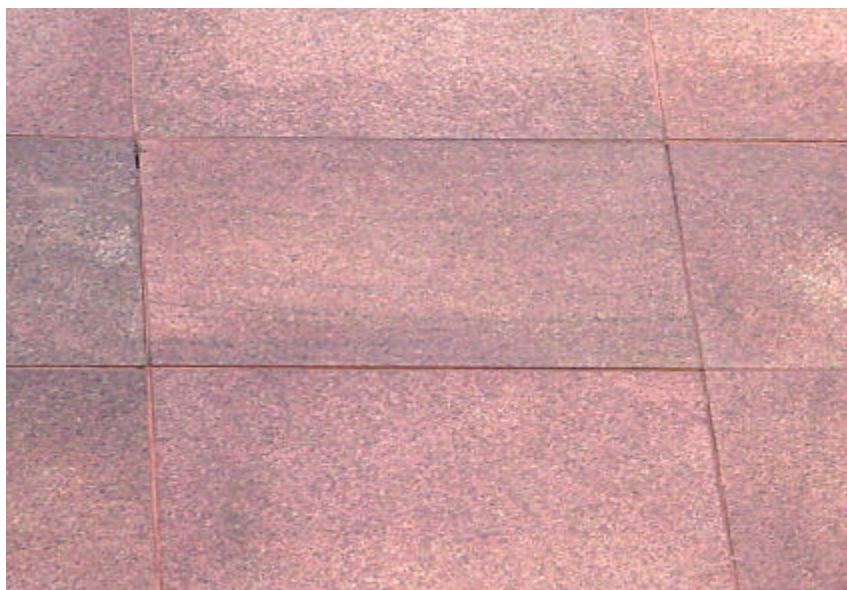
Photo no 10 État actuel du parement de granit existant à l'entrée principale (joints détériorés)
