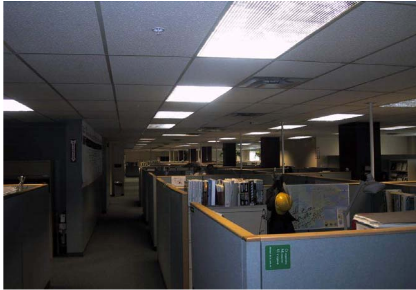
Photo no 1 État actuel du plafond dans le secteur des bureaux au 2e étage
