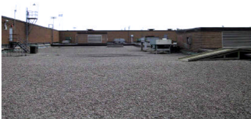
Photo no 20 Exemple de l'état actuel de la toiture
