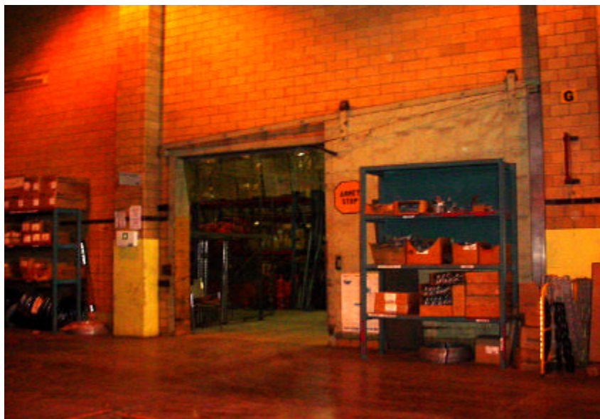
Photo n° 2 État actuel de la porte coupe-feu dans le mur entre les garages de stationnement et la partie Sud
