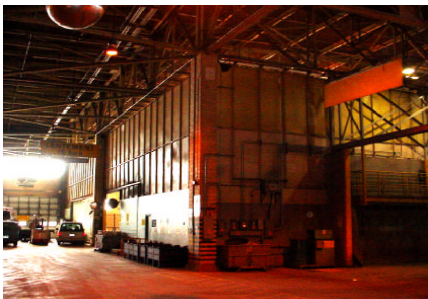
Photo n° 4 État actuel de la cloison séparant l'entrepôt de matières dangereuses des garages de stationnement
