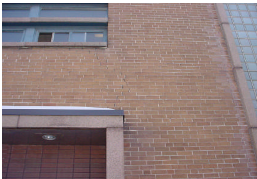
Photo no 4 État actuel du parement de briques existant (fissuration)
