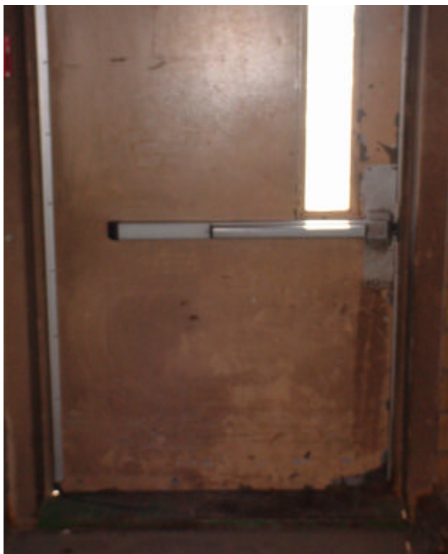
Photo no 17 État des portes à remplacer
