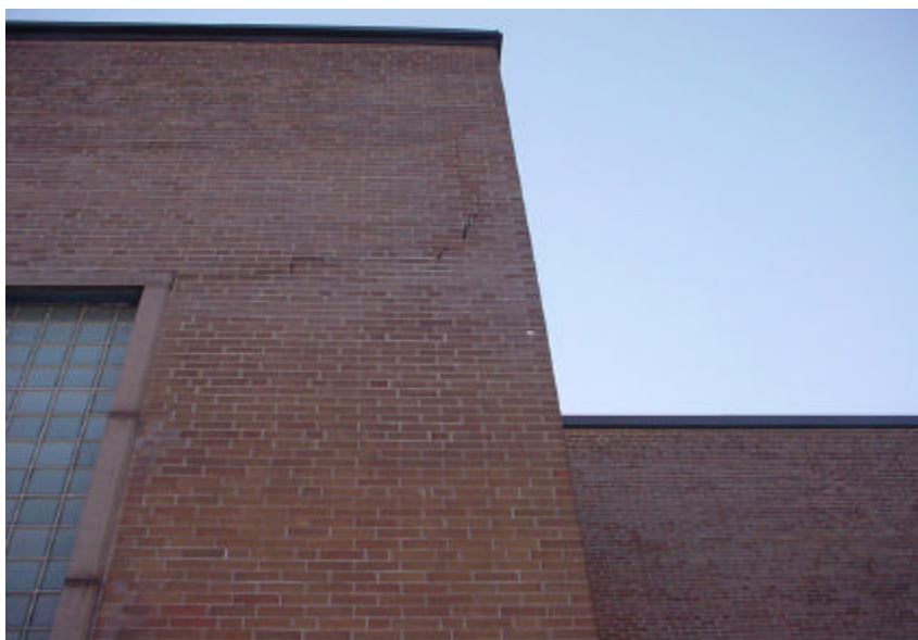
Photo no 3 État actuel du parement de briques existant (fissuration)
