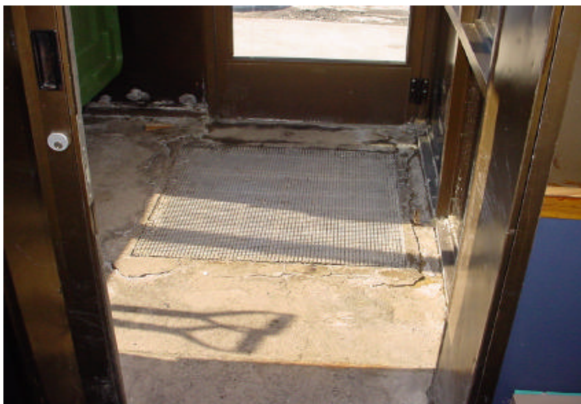
Photo n° 2 État actuel du plancher de béton à l'entrée
