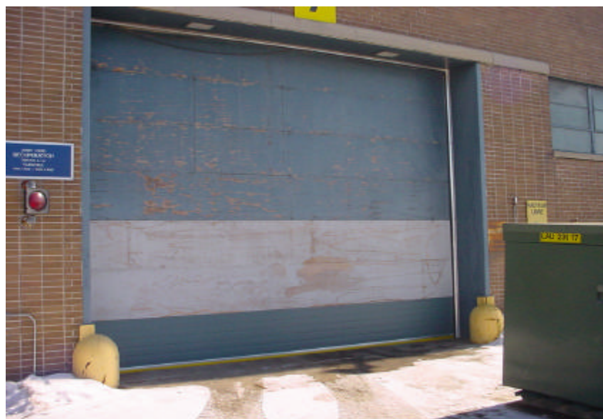
Photo no 19 Exemple de porte articulée à remplacer
