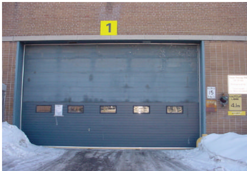
Photo no 18 Exemple de porte articulée à remplacer
