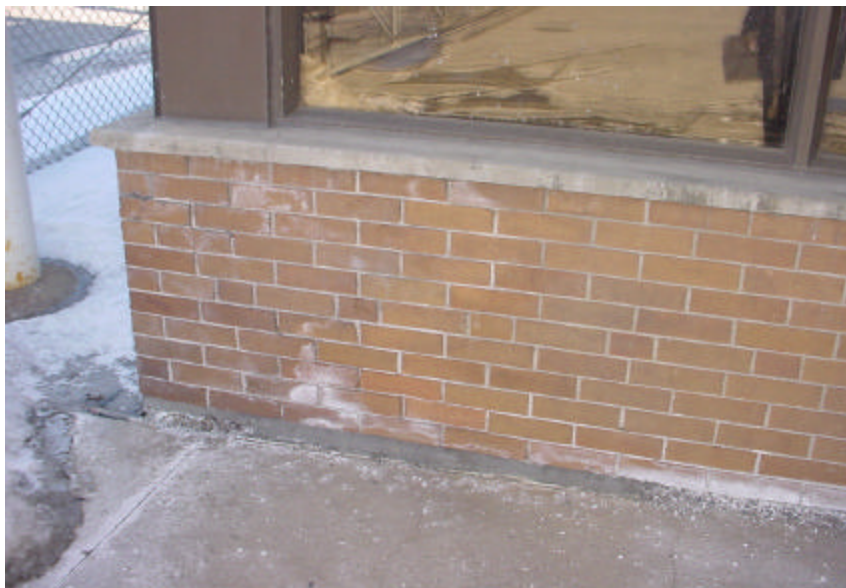
Photo n° 1 État actuel du parement de briques sous les fenêtres (fissuration et efflorescence)
