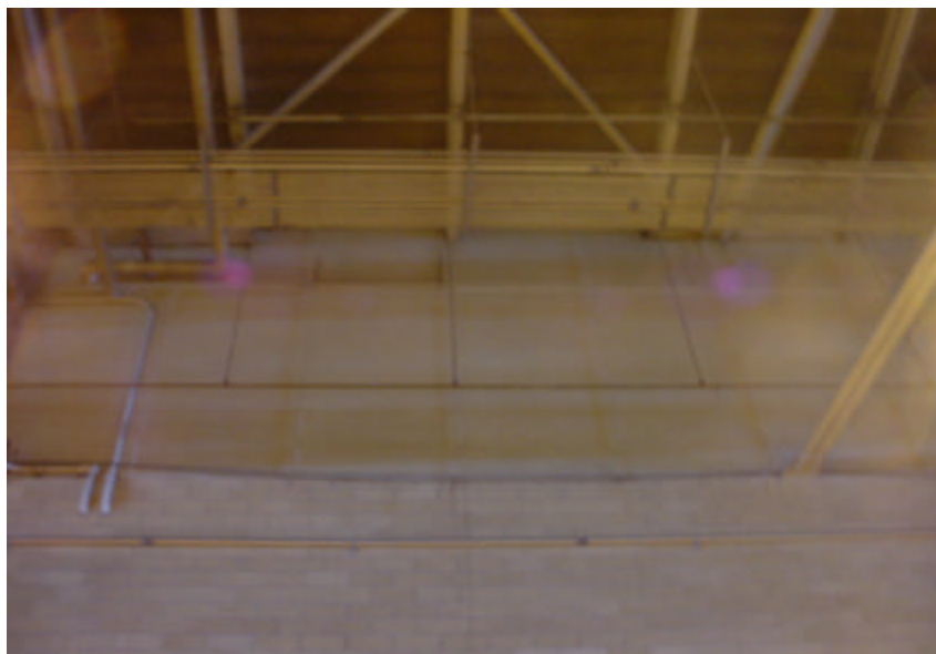
Photo n° 1 État actuel de la partie haute de la cloison séparant le garage de réparation et les garages de stationnement
