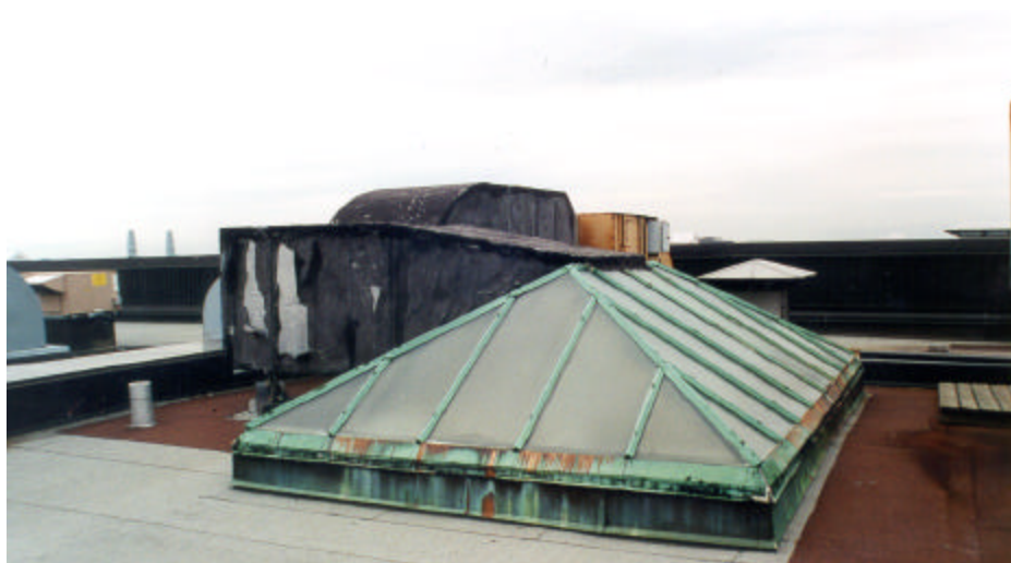
Photo no 22 État actuel du lanterneau dans le secteur de la chaufferie
