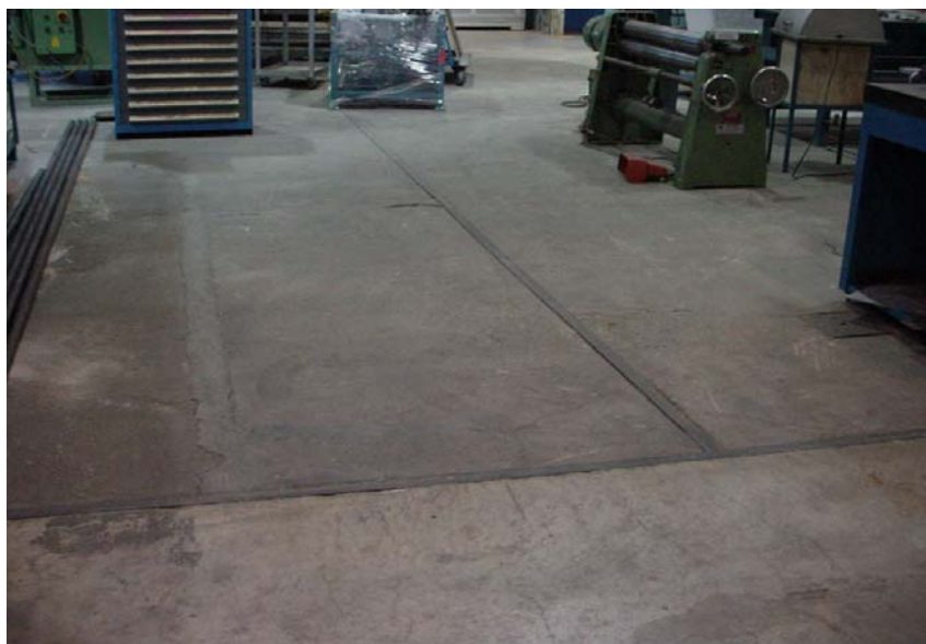
Photo no 5 État général des surfaces de plancher dans les ateliers
