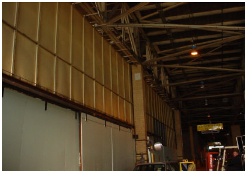
Photo n° 3 État actuel de la cloison séparant l'entrepôt de matières dangereuses des garages de stationnement
