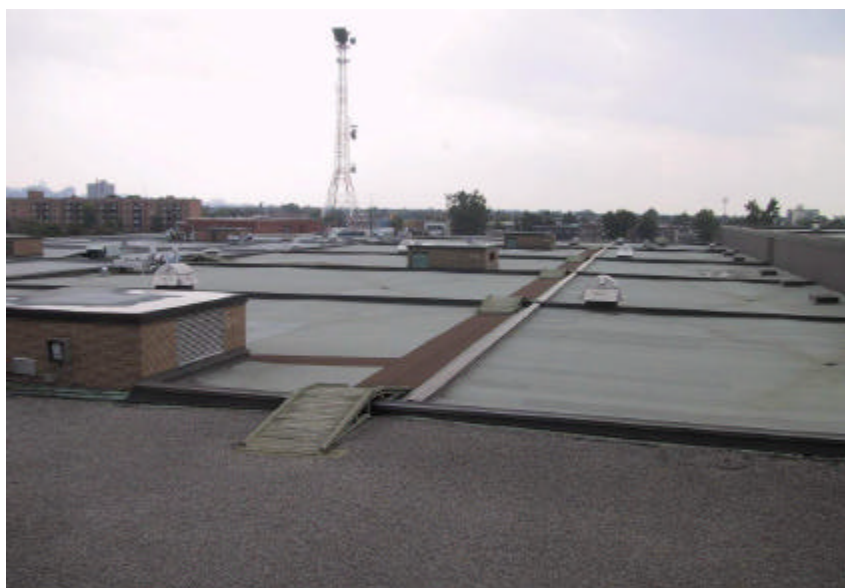
Photo no 21 Exemple de l'état actuel de la toiture
