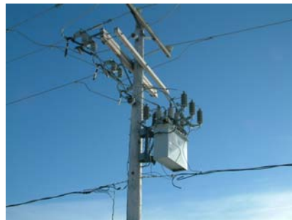
Disjoncteur du réseau de distribution
