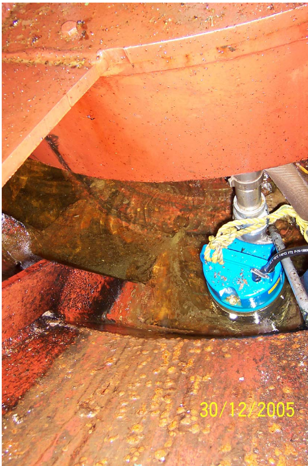
Figure 13: Bride d'accouplement du joint d'arbre (sous l'eau)
