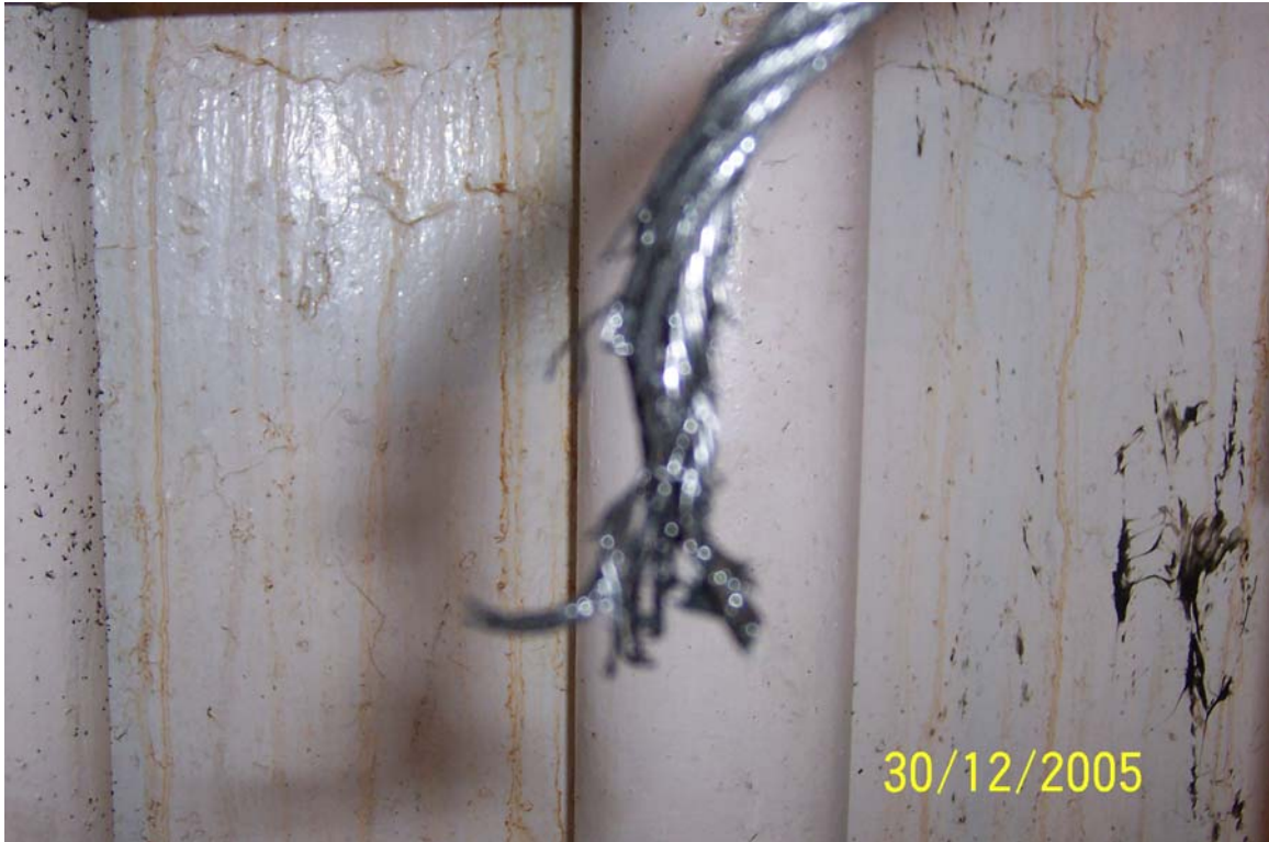
Figure 2: Câble de rétroaction sectionné
