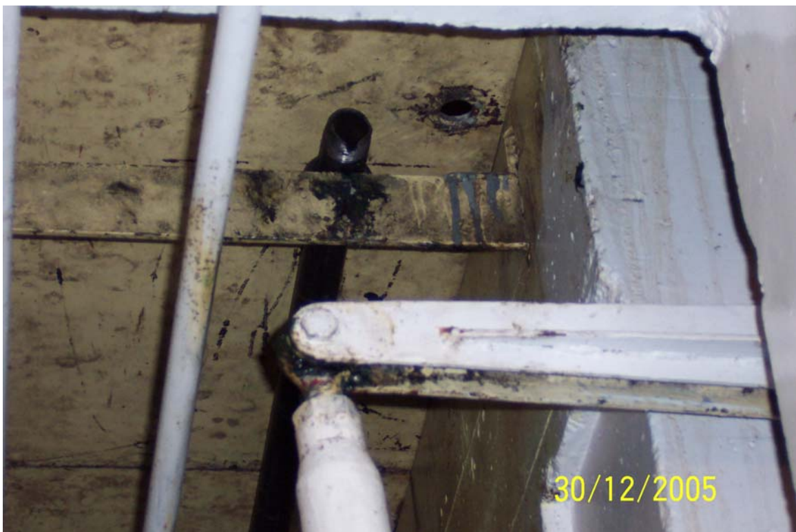
Figure 3: Tuyau de guidage de câble au point de rupture
