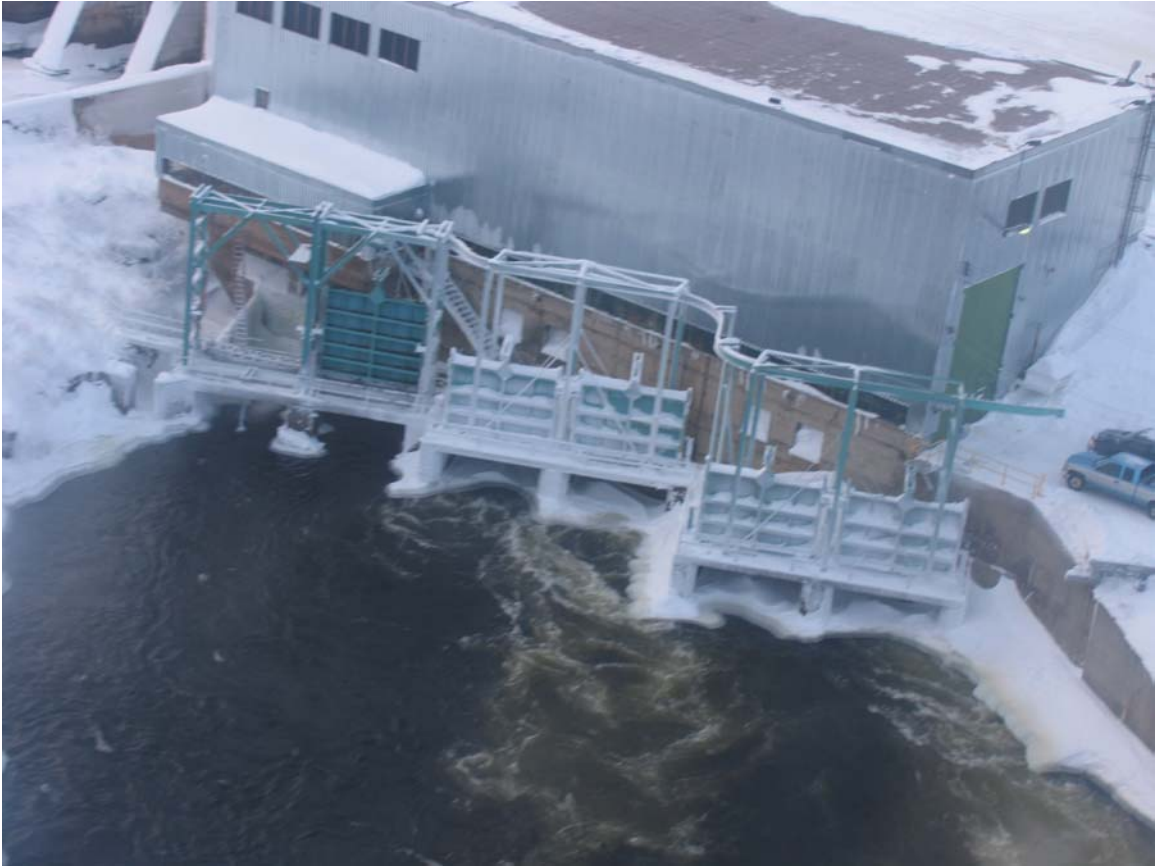
Figure 1: Vue de la centrale et des vannes aval
