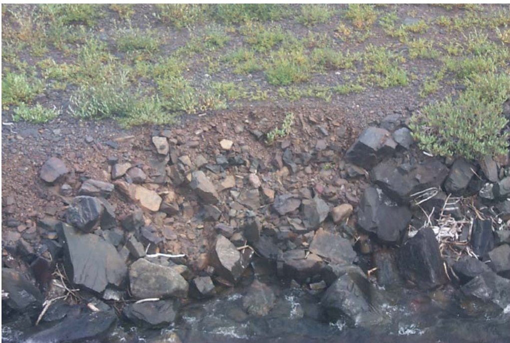
Photo 18: Affaissement du perré
