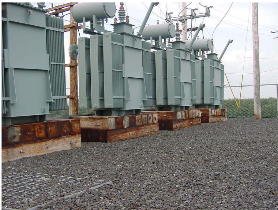
Photo 36: Socle n'est plus au niveau
