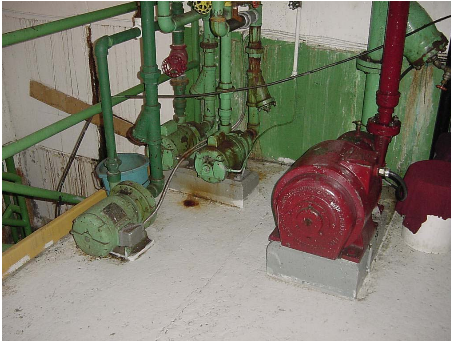
Photo 3: Pompes de refroidissement
