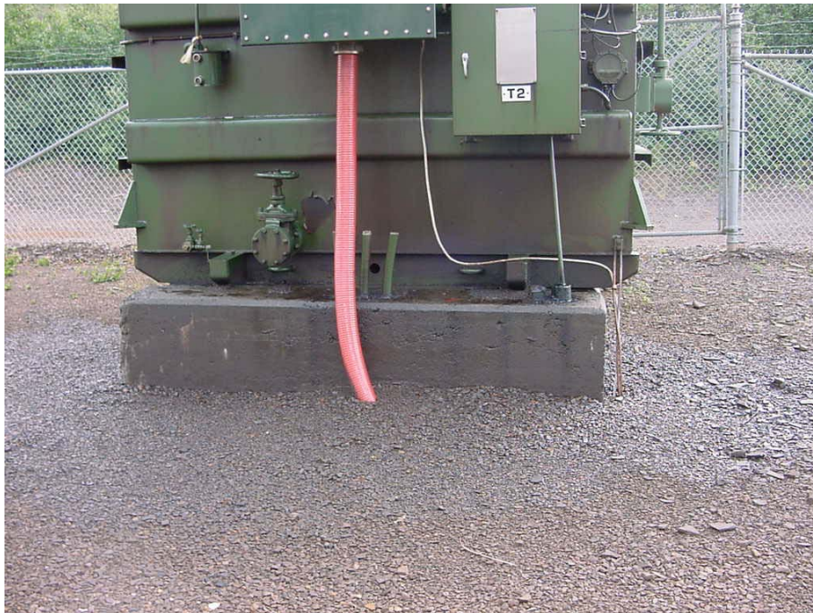
Photo 35: Fuite d'huile au T2 poste Schefferville
