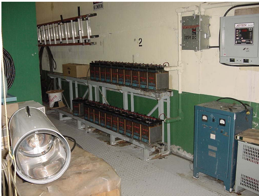
Photo 4: Banc de batteries dans la centrale
