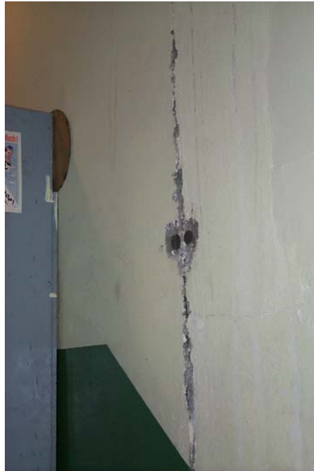
Photo 5: Fissure sur mur amont centrale
