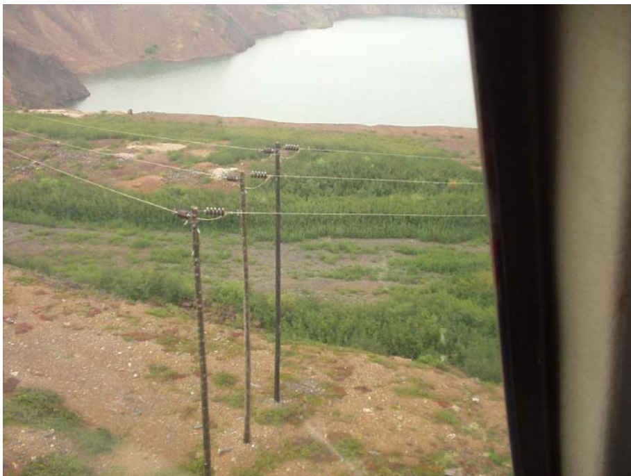
Photo 34: Poteaux de faible classe
