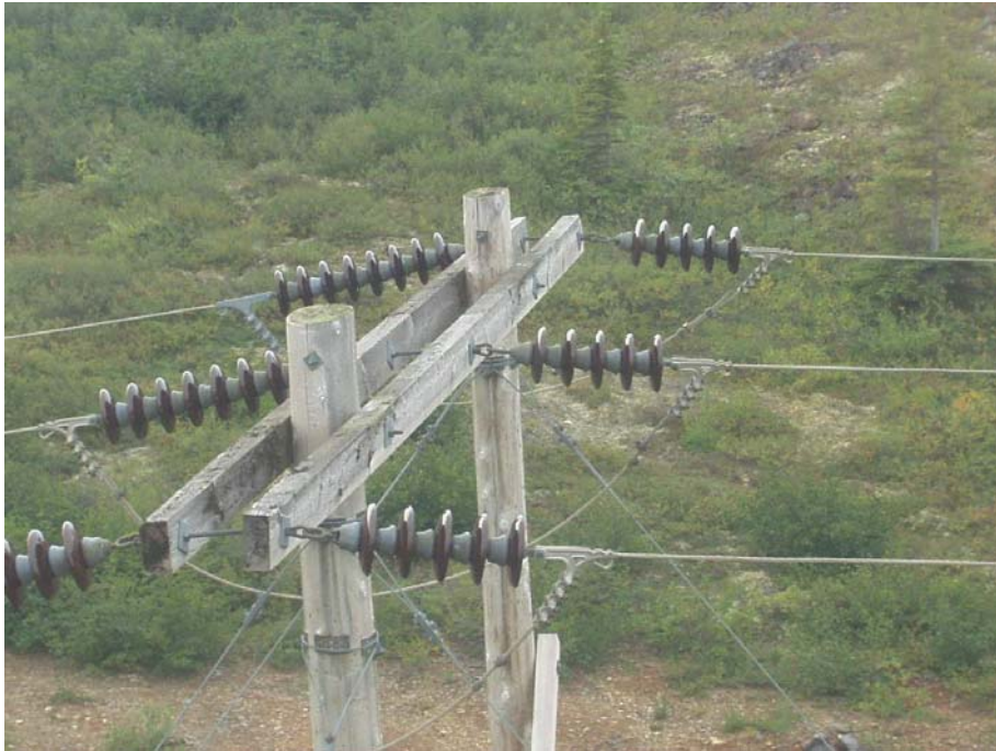
Photo 27: Champignons sur les structures
