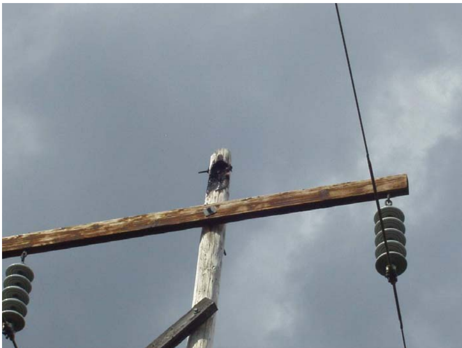
Photo 28: Incendie sur poteau
