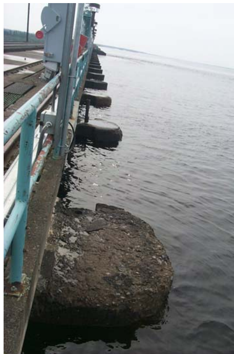
Photo 12: Dégradation du béton des piliers amont
