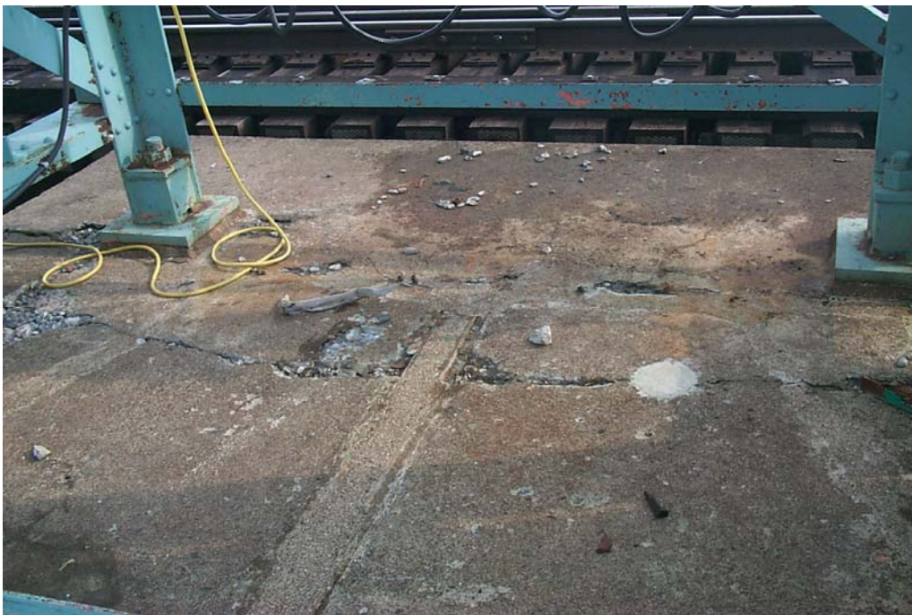
Photo 14: Fissure à l'évacuateur
