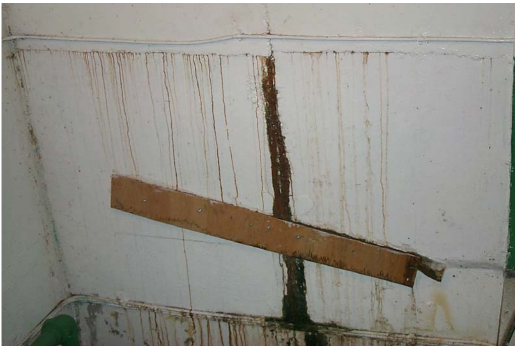
Photo 6: Fissure avec suintement, galerie
