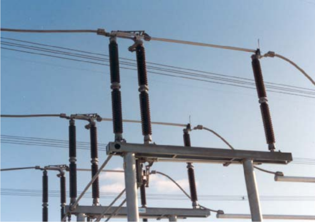
Photo 2 – Sectionneur dans un poste à 230 kV
