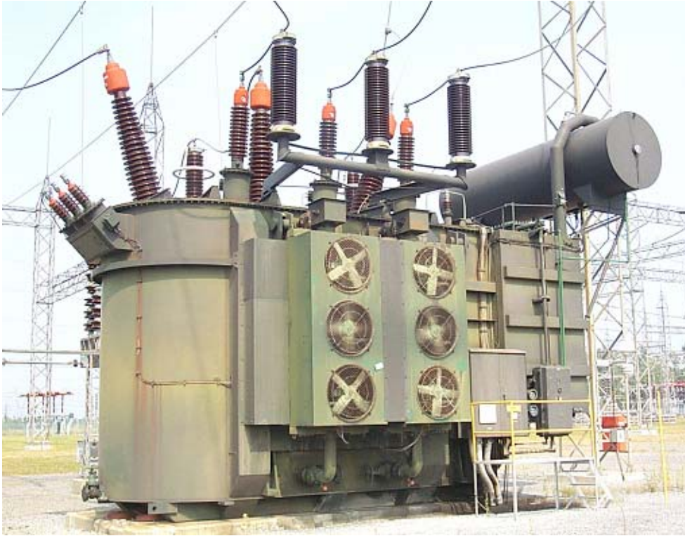
Photo 3 – Transformateur de puissance
