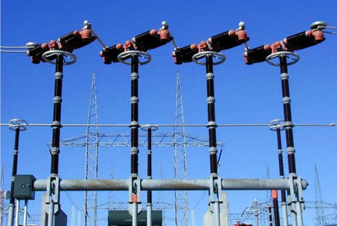
Photo 1 – Disjoncteur dans un poste à 735 kV
