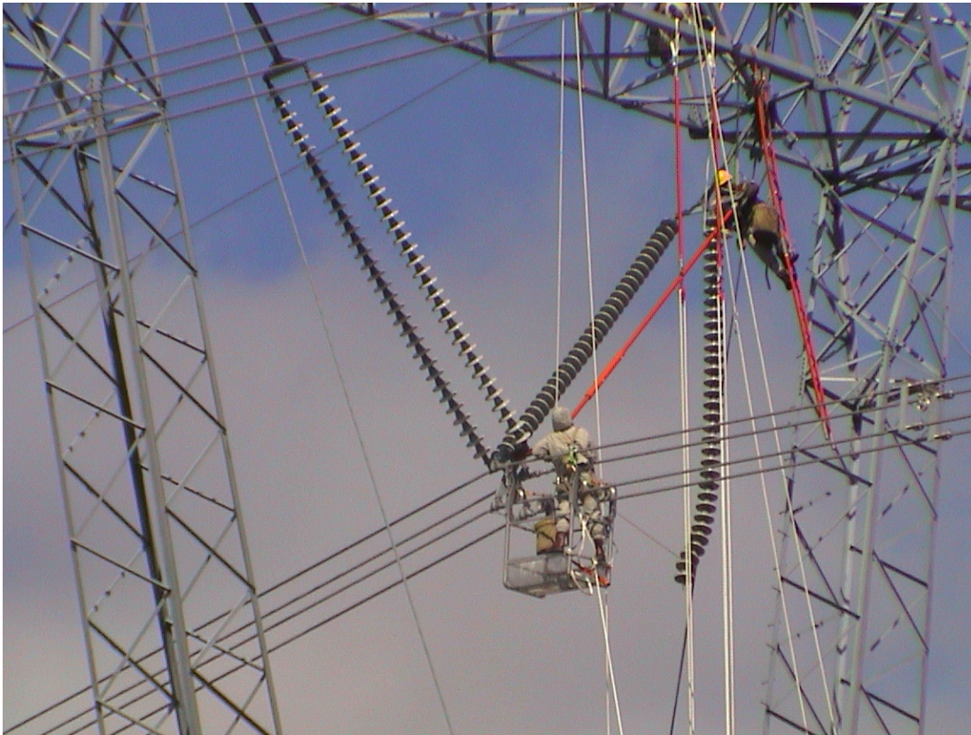
Photo 8 – Chaîne d'isolateurs d'une ligne à 735 kV
