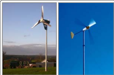
Éolienne Proven 6kW
