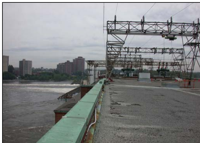
Figure 2 - Emplacement des transformateurs sur le palier en aval de la centrale
