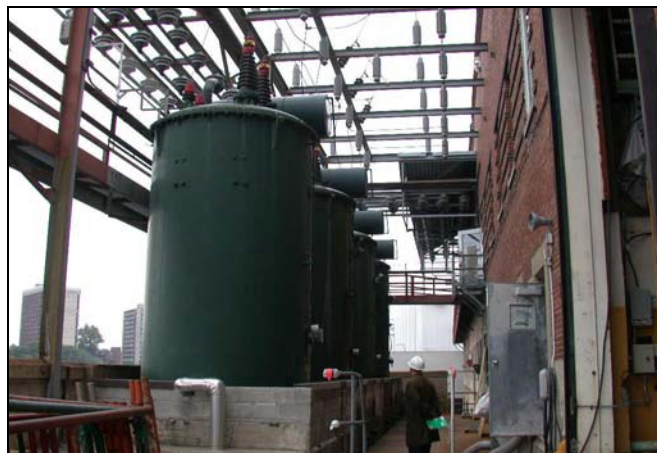
Figure 3 - Installation des équipements du poste sur le toit de la centrale Rivière-des-Prairies
