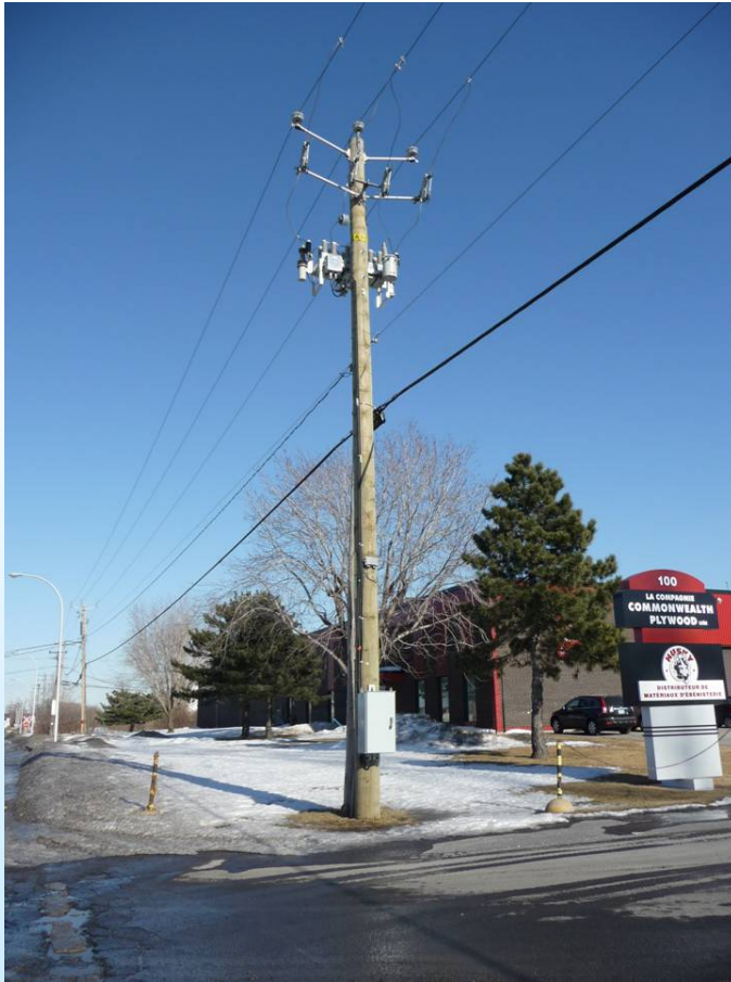
Batterie de condensateurs Projet pilote
