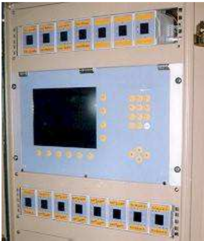
Gestion complète d'une cuisine avec écran de supervision.
