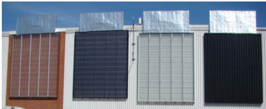
Figure 1-1 : Collecteurs solaires au CTGN
