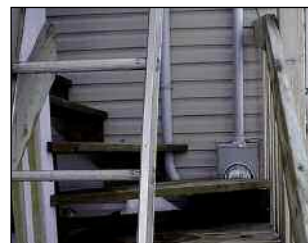
Compteur encastré dans un escalier
