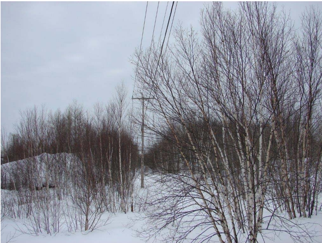
Photos 3 et 4 : Chemin ne permettant pas l'accès aux équipements d'Hydro-Québec.
