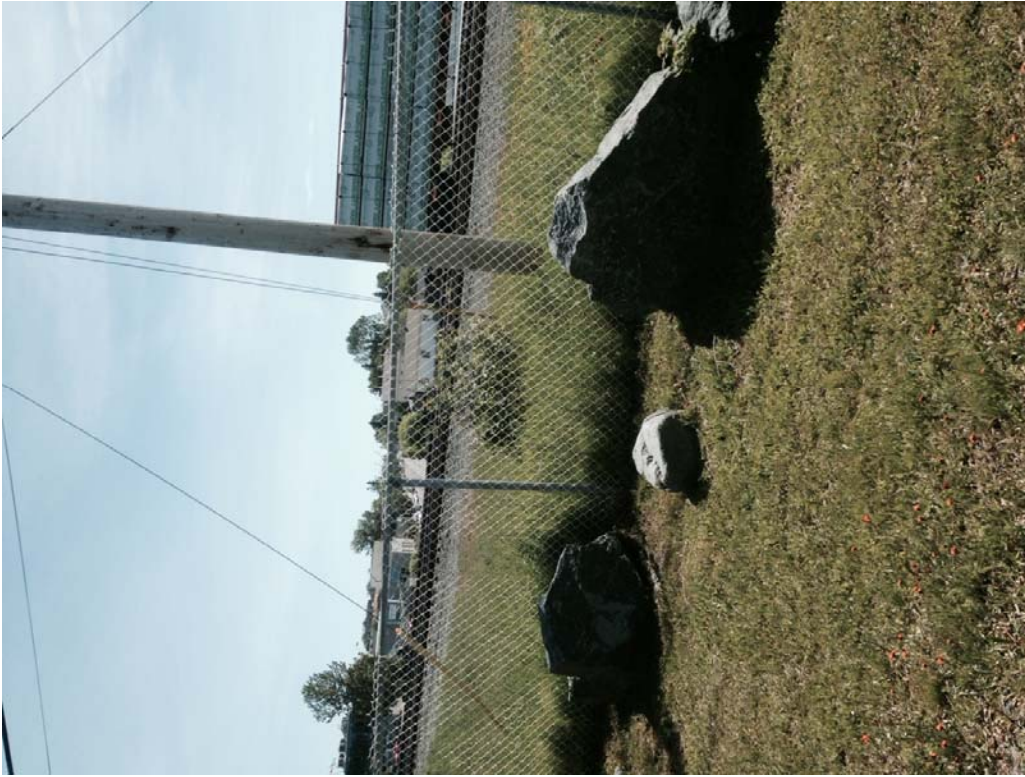
PHOTO E-2.4 : RÉSEAU AÉRIEN EXISTANT PRÈS DE LA VOIE FERRÉE À PROXIMITÉ DU BOULEVARD RIDEAU – DÉGAGEMENT INSUFFISANT
