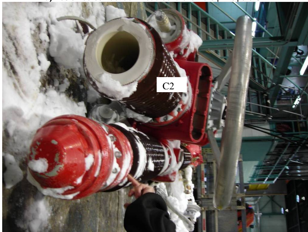
b) Bris de la chambre principale et auxiliaire du contact C2.
