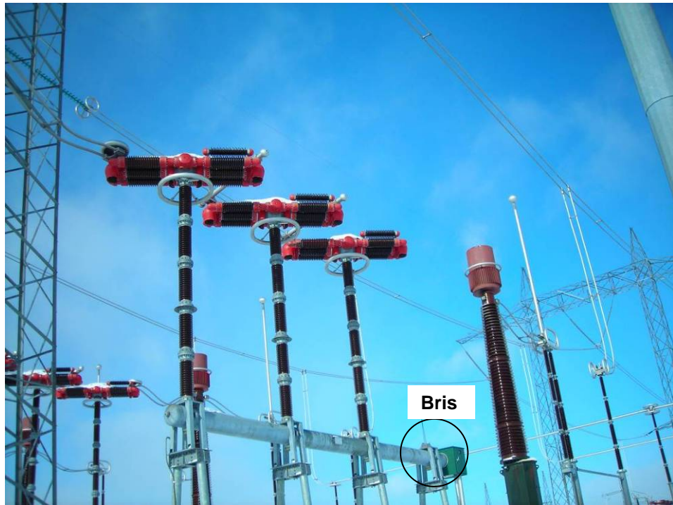
a) Vue frontale du disjoncteur 700-35
