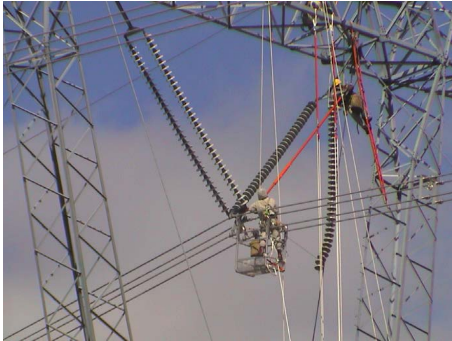
Photo 7 Chaînes d'isolateurs d'une des trois phases d'un circuit à 735 kV
