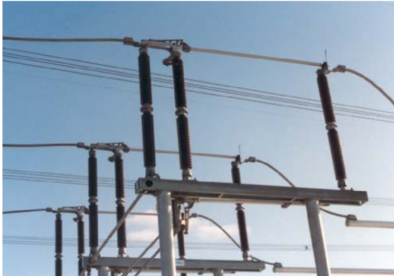
Photo 2 Trois phases d'un sectionneur dans un poste à 230 kV
