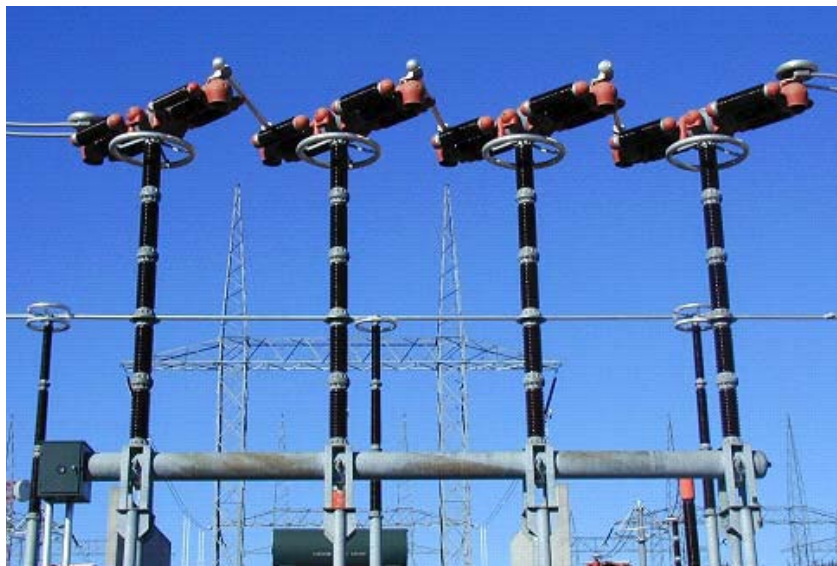
Photo 1 Une des trois phases d'un disjoncteur dans un poste à 735 kV
