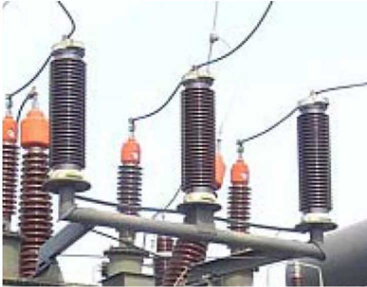
Photo 5 Trois parafoudres installés sur un transformateur de puissance
