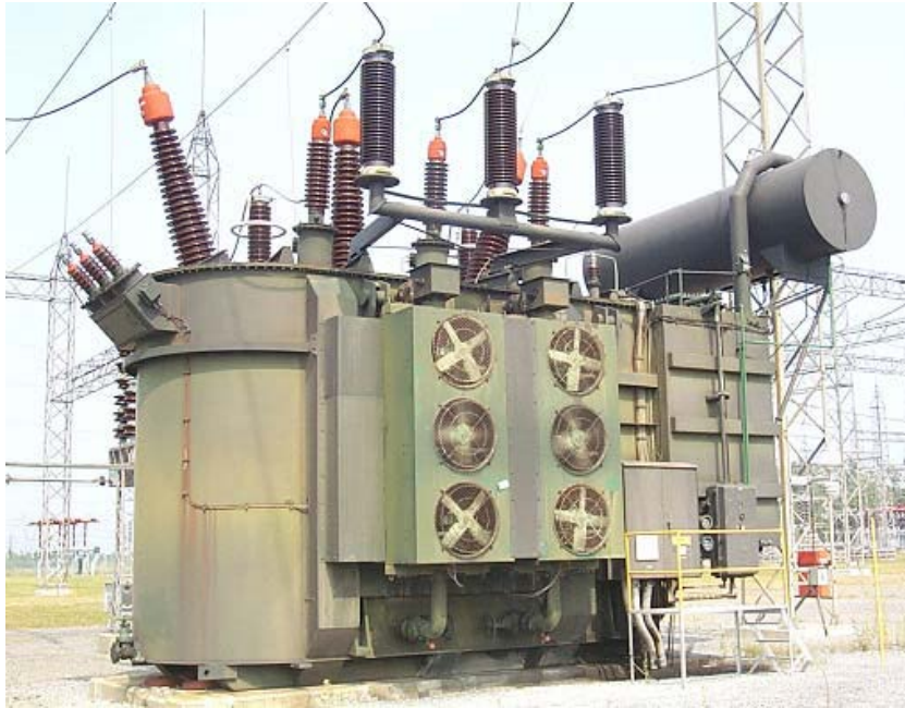
Photo 3 Transformateur de puissance triphasé
