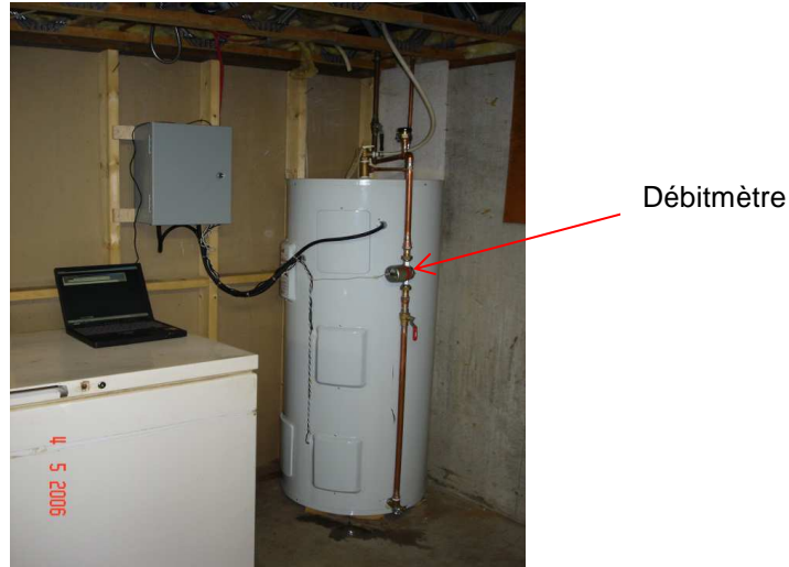
Figure 1 : Mesure de consommation d'eau avec débitmètre 1
