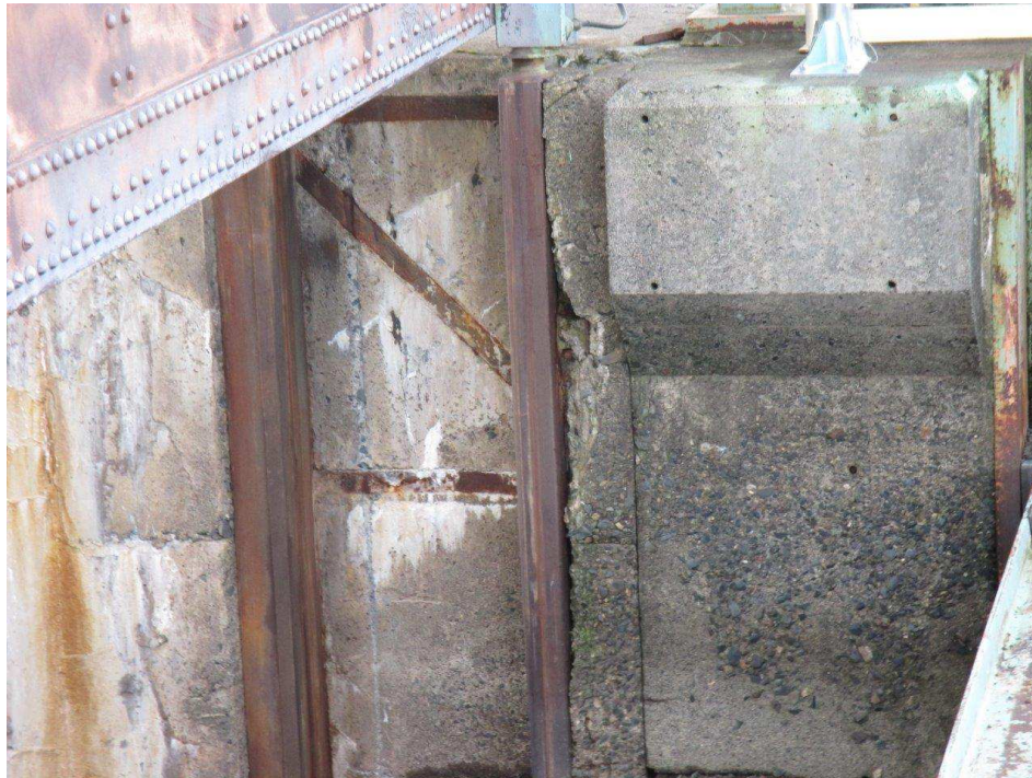
FIGURE 4 : ÉTAT DES RAILS DE GUIDAGE LATÉRAL
