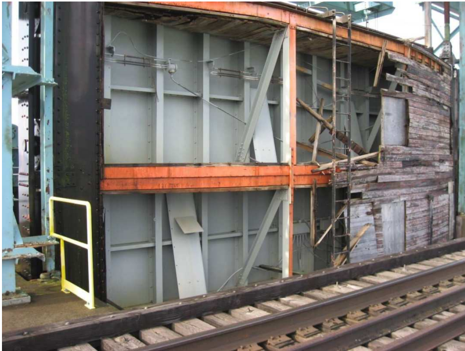
FIGURE 2 : PAREMENT D'UNE VANNE ARRACHÉ, CÔTÉ AVAL
