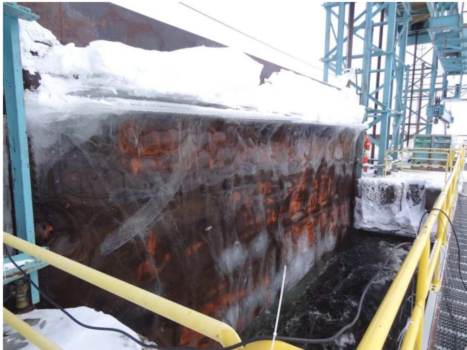
FIGURE 5 : ACCUMULATION DE PLUSIEURS TONNES DE GLACE SUR UNE VANNE
