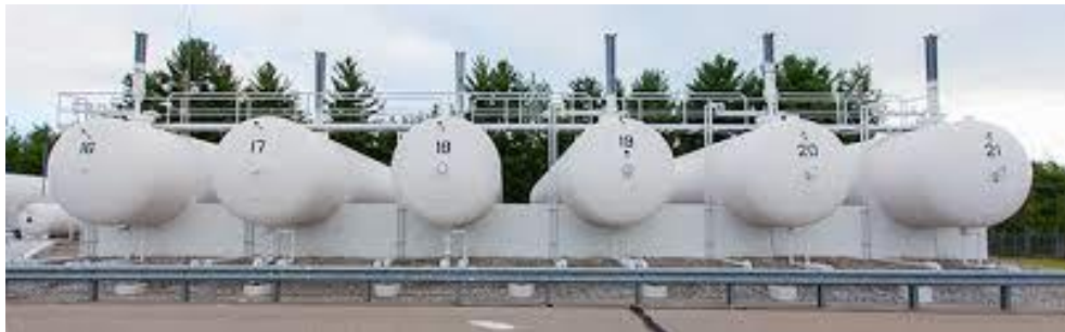
Figure 14 Installation commerciale pour grand utilisateur de propane
