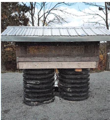
Figure 2 - Photo puits canadien (18 octobre 2018)
