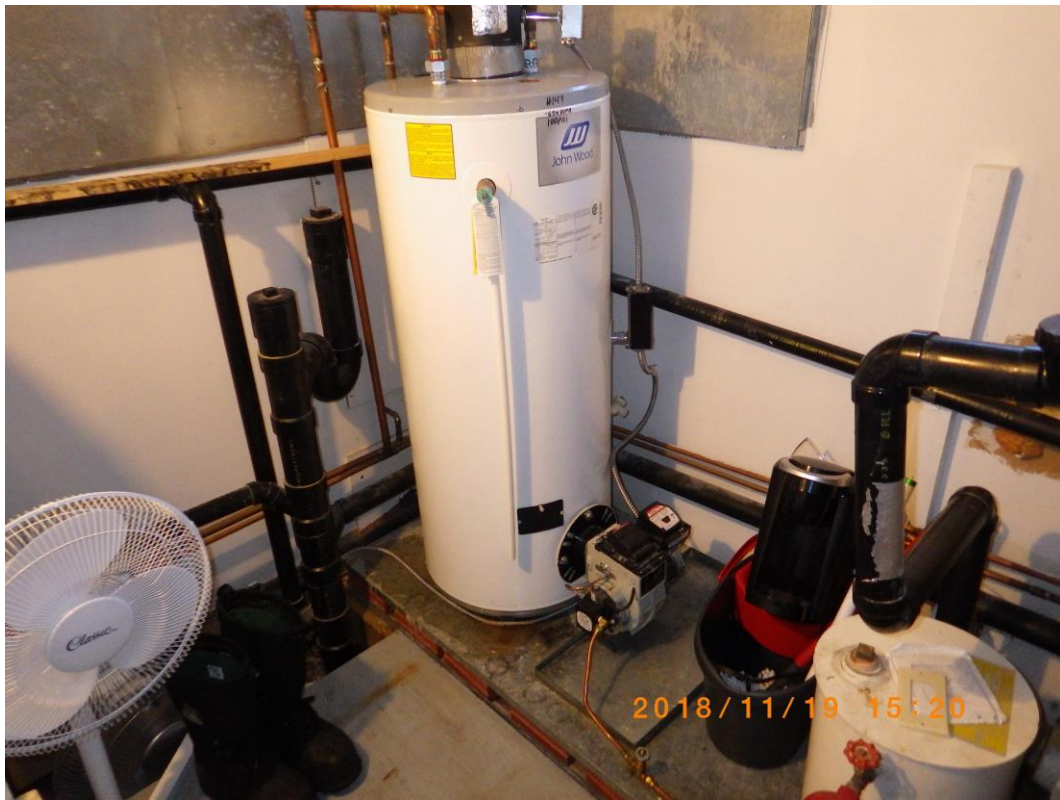
Chauffe-eau au mazout
