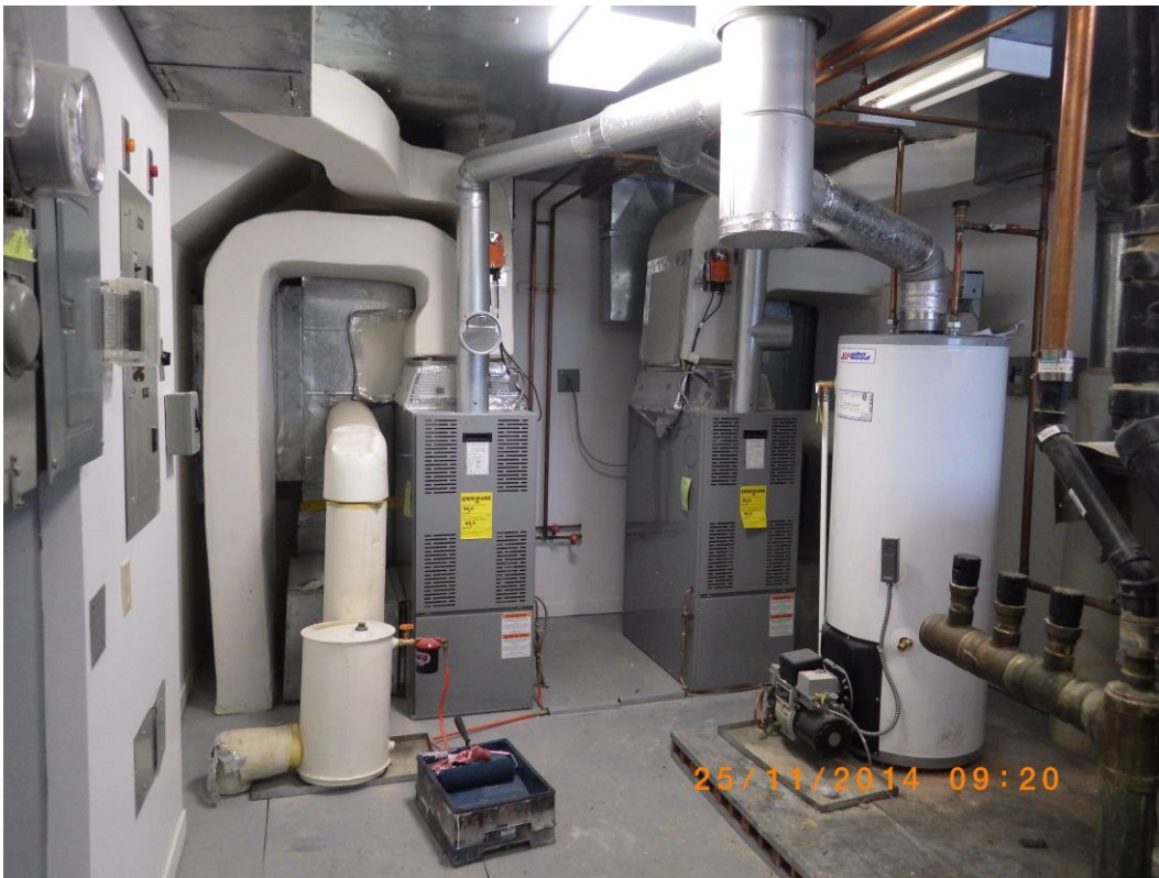
Équipement de chauffage type du J2.2. (fournaise et chauffe-eau au mazout, entrée d'air sur la fournaise et entrée d'air de combustion)
