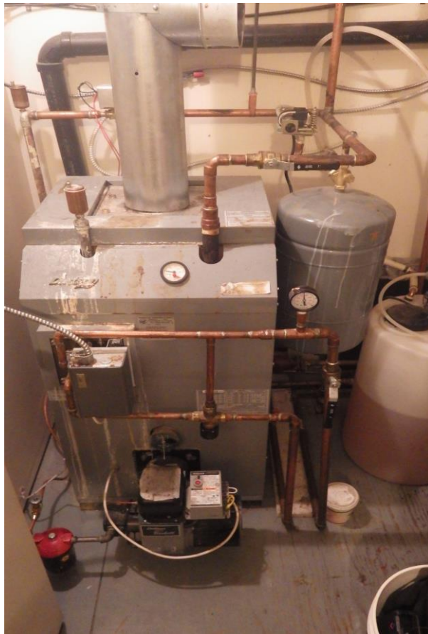
Chaudière au mazout
