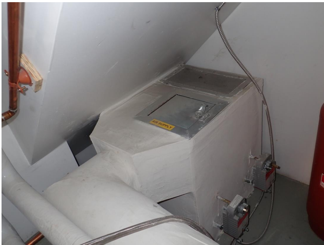
Entrée d'air de combustion
