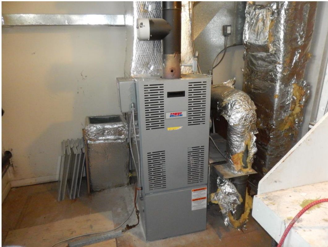
Fournaise au mazout, entrée d'air frais sur la fournaise et entrée d'air de combustion
