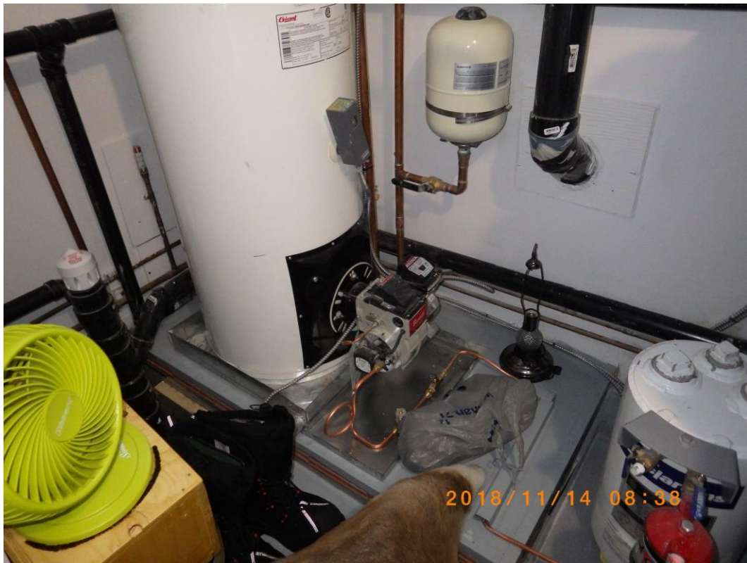
Chauffe-eau au mazout
