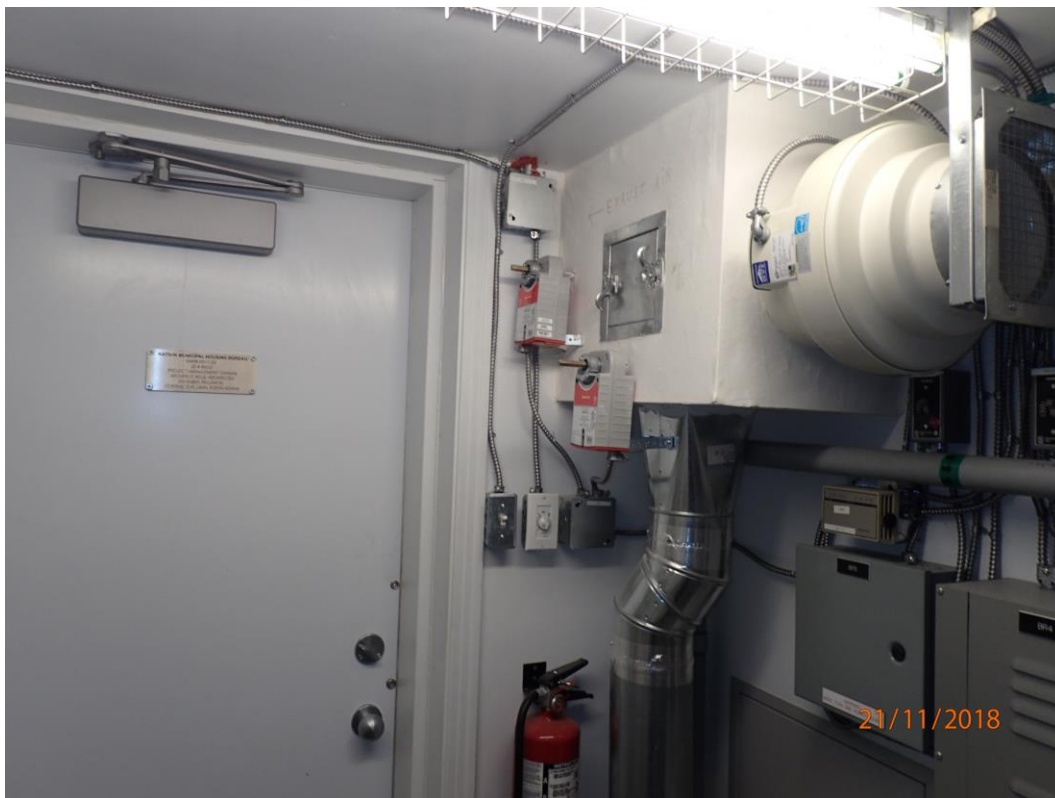
Ventilateur (en cas de surchauffe de la chambre mécanique)
