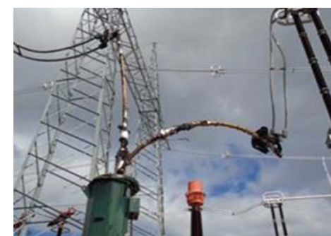
Transformateur de courant après défaut
