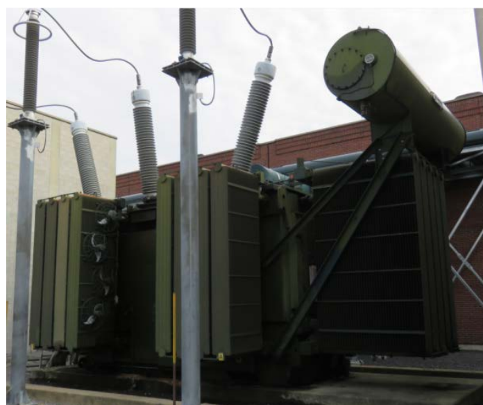
Transformateur avec changeur de prise
