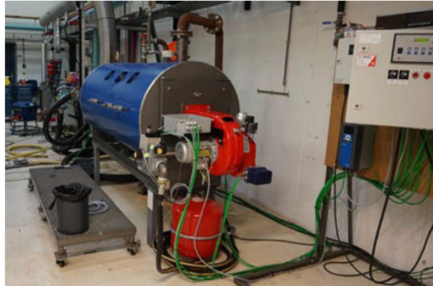
Figure 6-28 : Chaudière de 475 kW équipée d'un brûleur à tirage forcé de 475 kW [66]
