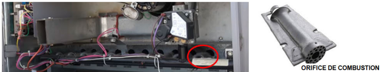
Figure 6-9 : Brûleur dans un climatiseur de toit (à gauche, cercle rouge) et brûleur à flamme horizontale (à droite)
