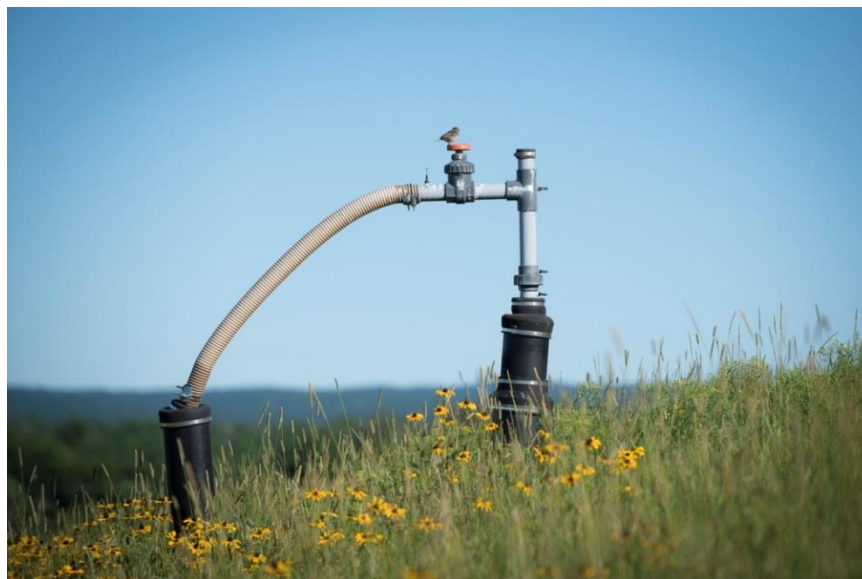
Photo 2.4 Puits vertical de captage des biogaz sur l'ancien site
