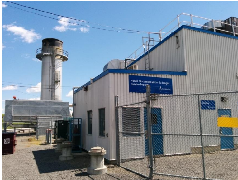
Photo 2.3 Poste de compression du biogaz
