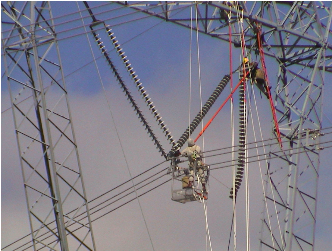
Photo 8 – Chaîne d'isolateurs d'une ligne à 735 kV
