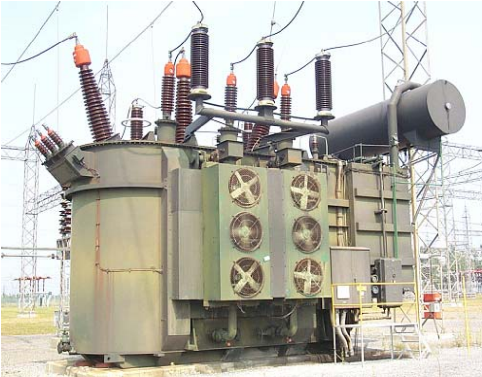
Photo 3 – Transformateur de puissance
