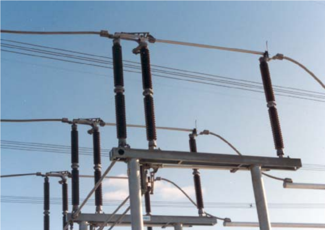
Photo 2 – Sectionneur dans un poste à 230 kV
