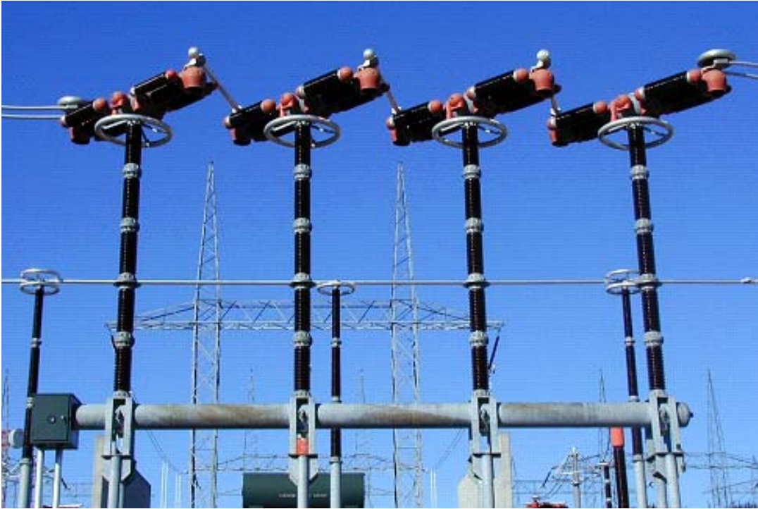
Photo 1 – Disjoncteur dans un poste à 735 kV
