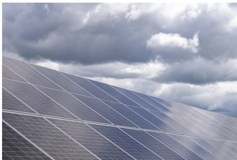
Photo: Christine Muschi Archives La Presse canadienne Des panneaux solaires de la centrale Robert-A.-Boyd d'Hydro-Québec, à Varennes
