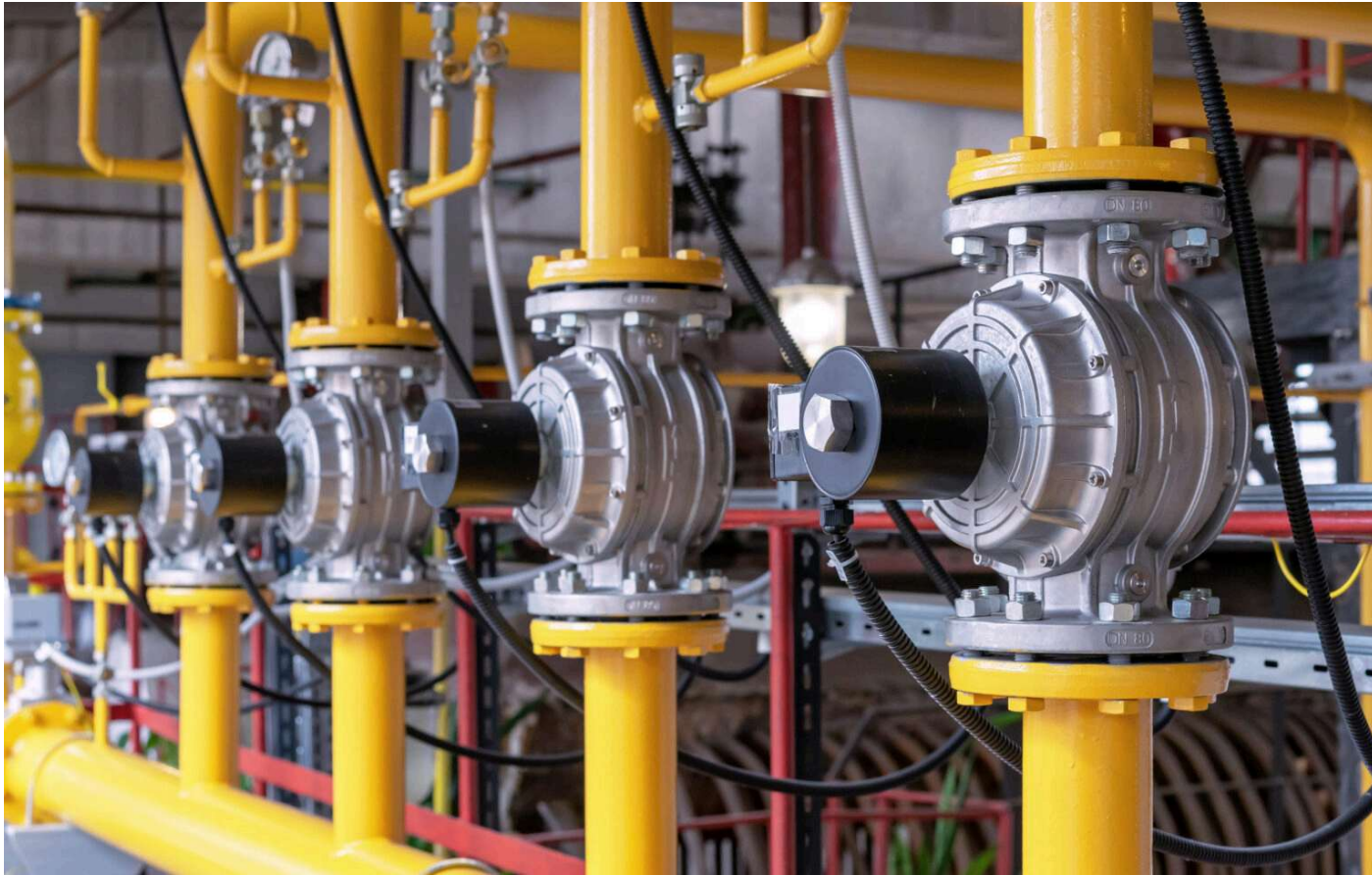
Équipements de chaufferie à gaz, dotés d'une conduite de gaz avec vanne de sécurité (Photo: 123RF)
